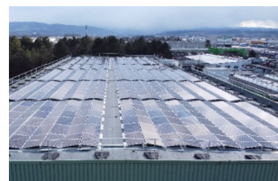
Photovoltaikanlage St. Pölten
